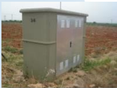
Caseta de hidrante
