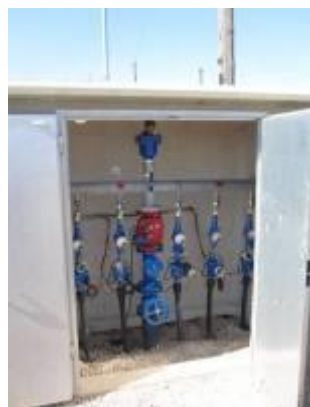
Interior de hidrante
